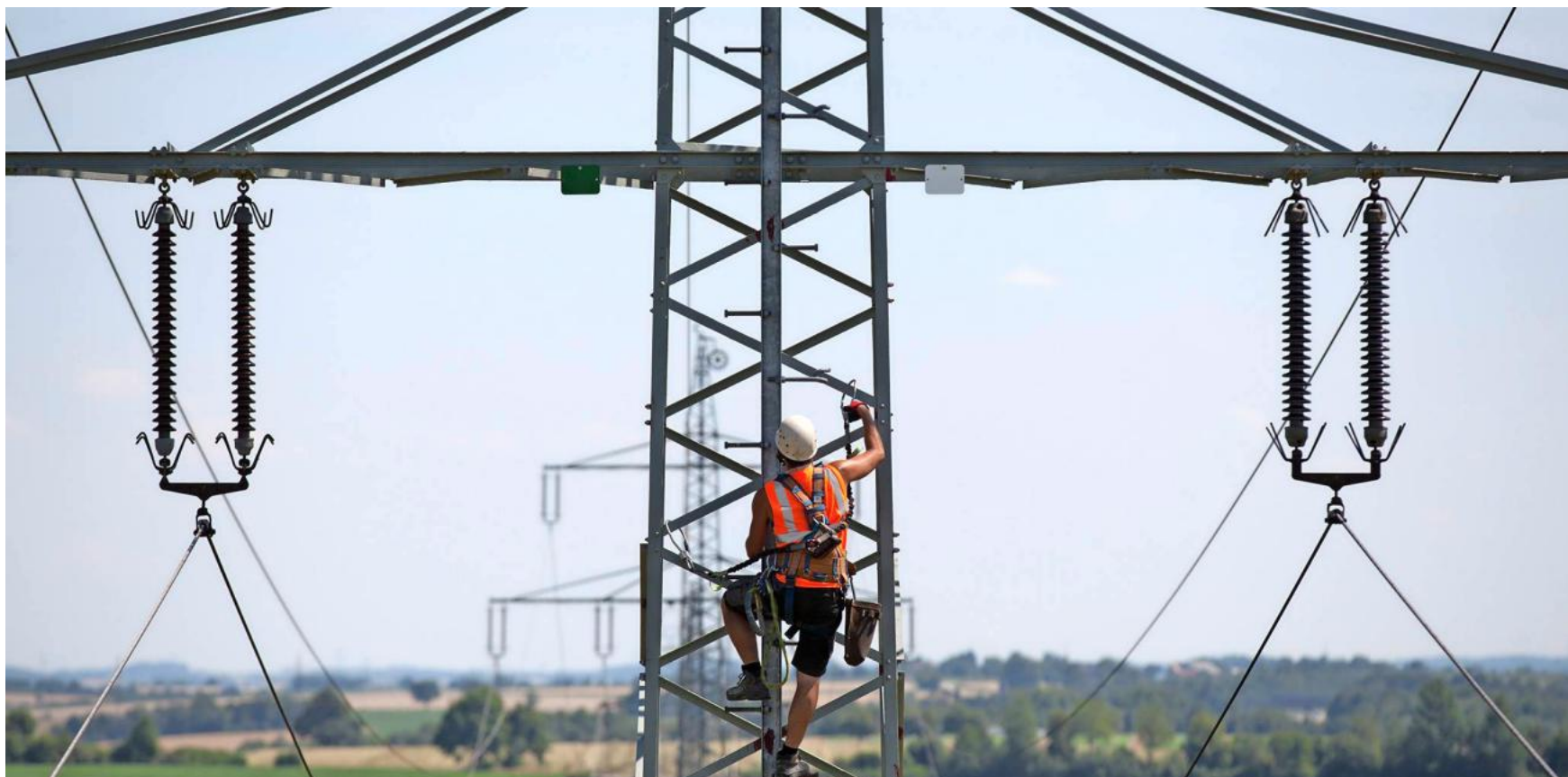
Die dezentrale Erzeugung und Einspeisung von nicht ständig zur Verfügung stehenden erneuerbaren Energien stellt große Anforderungen an das Stromnetze der Zukunft. FOTO: ENBW
