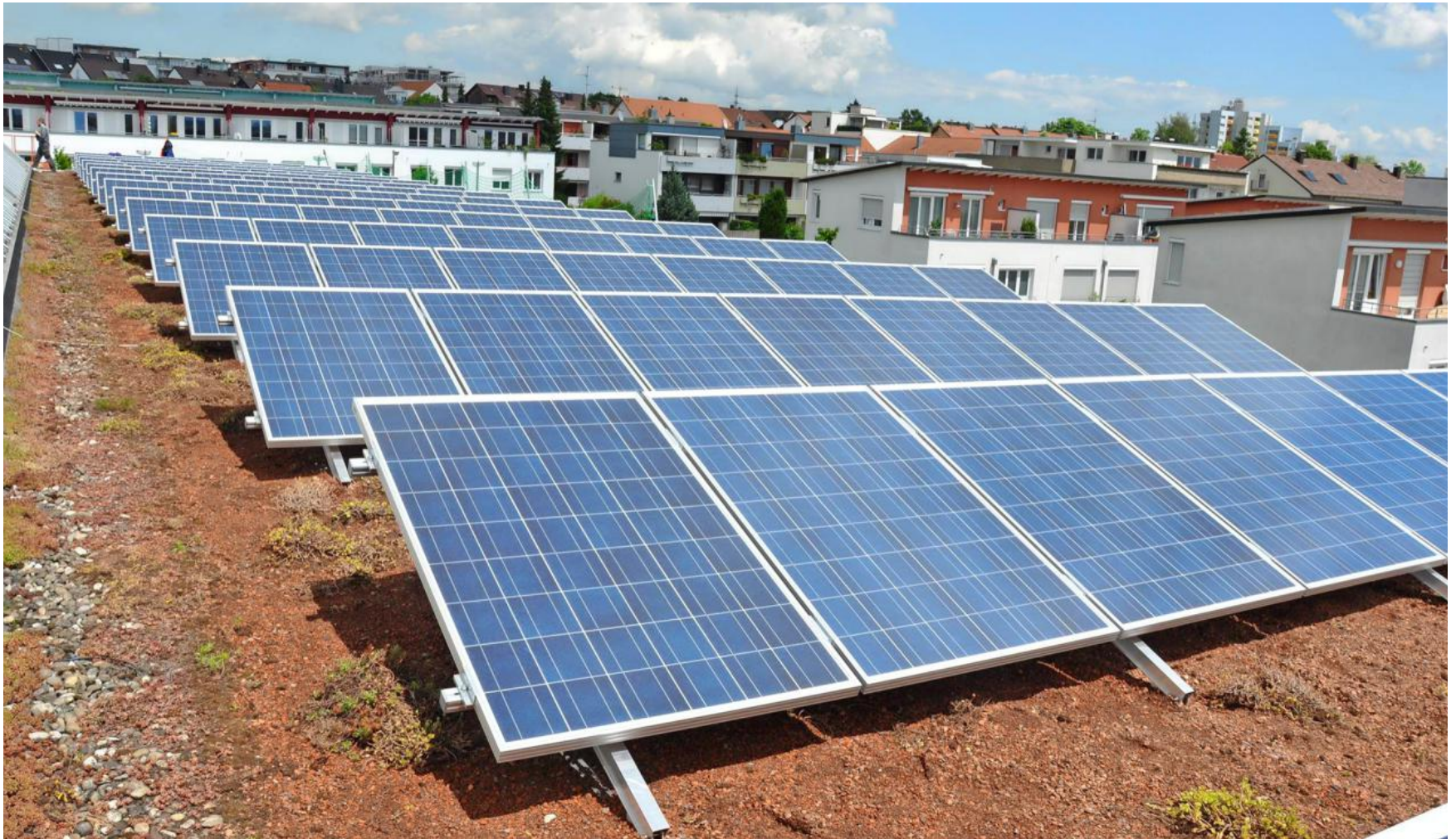
Ob bei der Wärmeversorgung oder bei der Stromgewinnung: das Land möchte den Ausbau der Solarenergie fördern. Weitere 50 000 Dächer sind im Gespräch. FOTO: UMWELTMINISTERIUM
