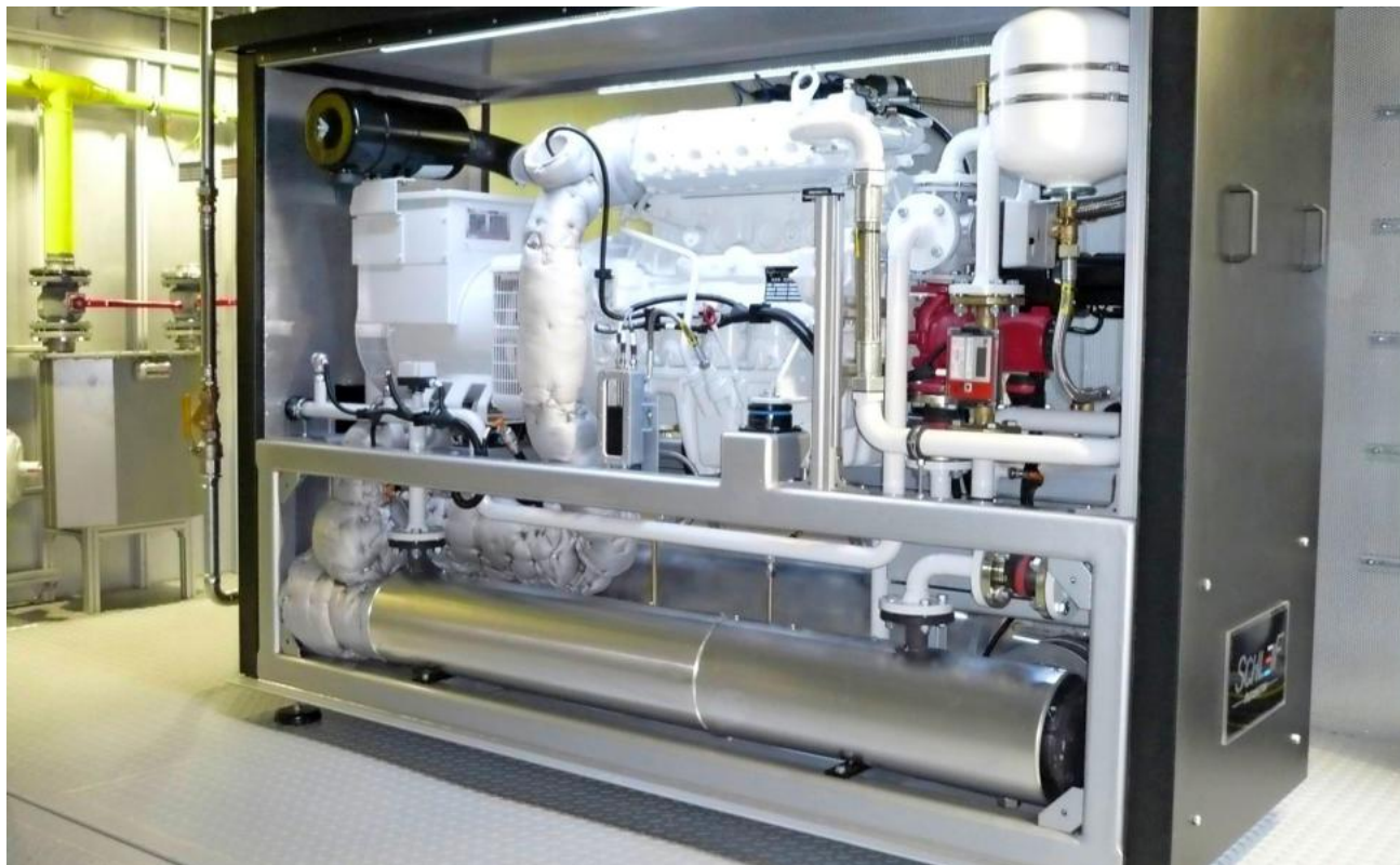
Kraft-Wärme-Kopplungsanlagen vermindern Energieverluste. FOTO: UMWELTMINISTERIUM
