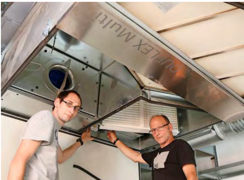
Tobias Krattenmacher und Werner Sauter vom Hochbau und Gebäudemanagement der Stadt Biberach zeigen ein Deckengerät der dezentralen Lüftungsanlage.
