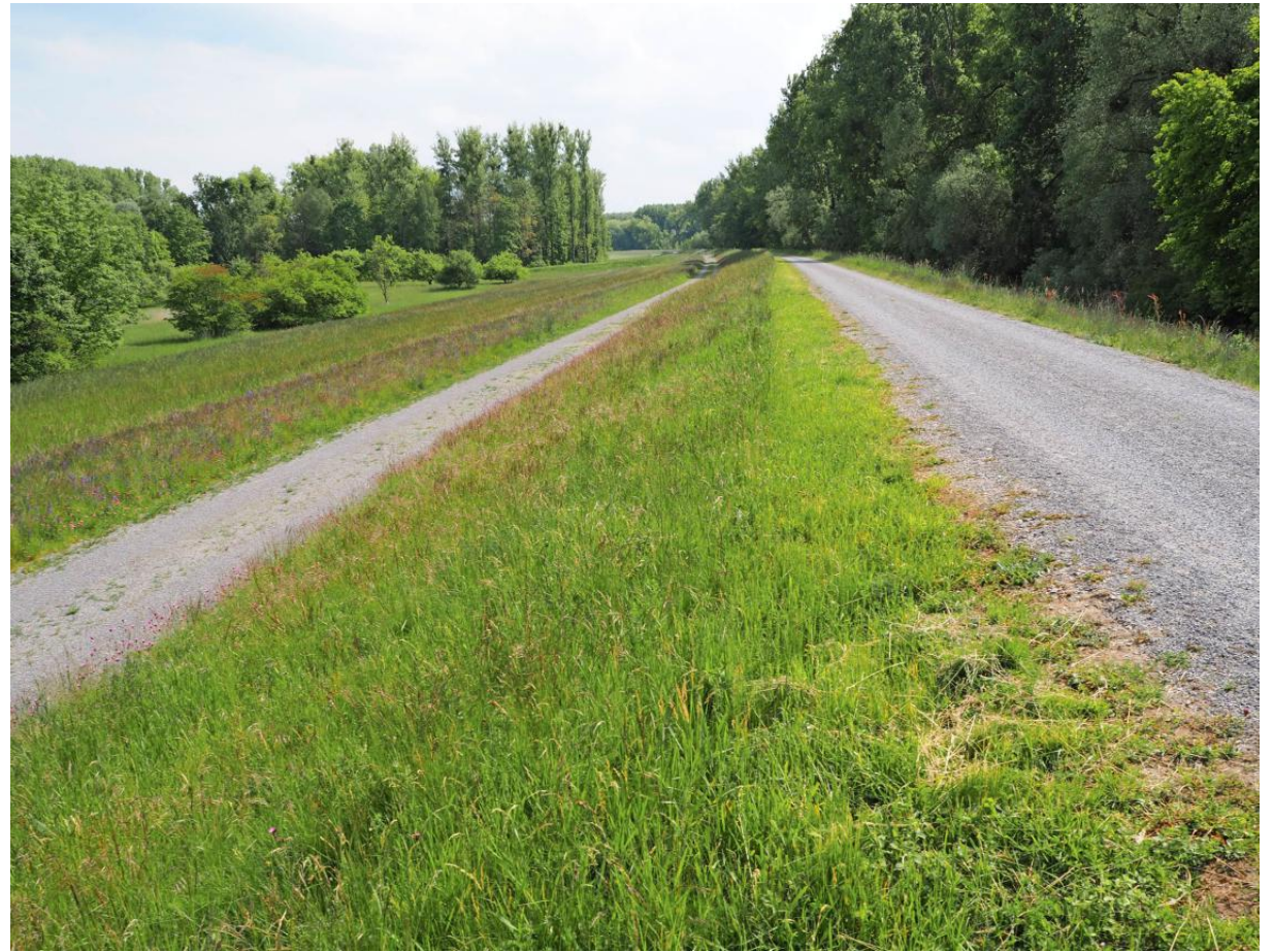
Der Dammverteidigungsweg (links) gewährleistet, dass der Damm auch bei Hochwasser mit schweren Fahrzeugen erreichbar ist.
