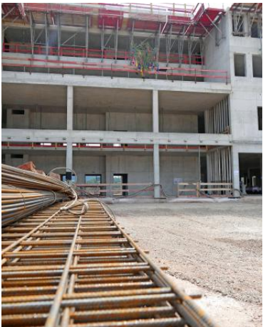
Nach der Fertigstellung soll die Klinik ihren Strom weitgehend selbst erzeugen.
